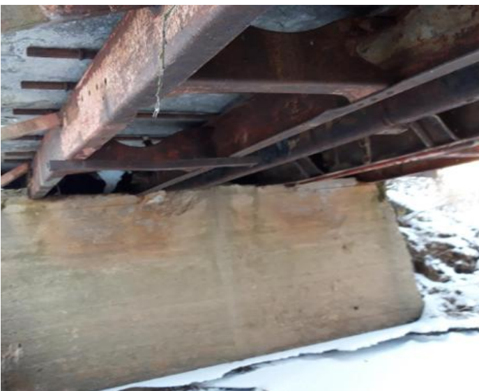
Ajoneuvorunko pääkannattajana. Tällaisen kantavuuden määrittäminen on vaikeaa. Myös betonissa näkyy lohkeamaa. Siltatarkastuksen ja mahdollisen uusimishankkeen tarve.
