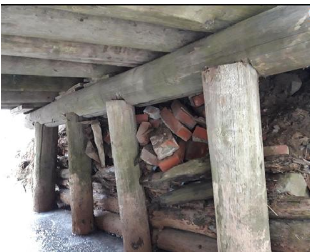
Lahovaurioita ja sortumia puisessa maatuessa sekä perustuspylväissä. Tilanne edellyttää kiireellistä sillantarkastusta, korjaustoimenpiteitä ja painorajoituksen asettamista.
