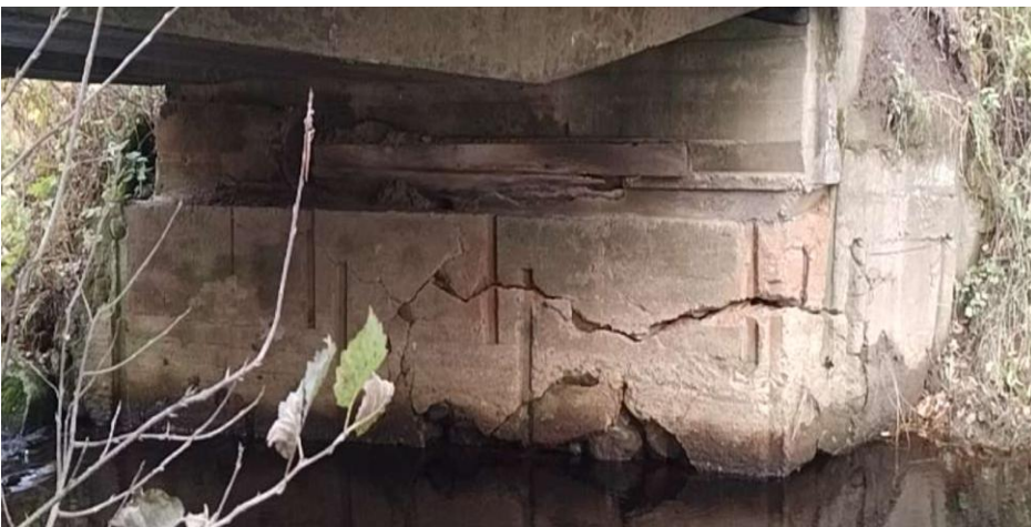
Murtumia ja halkeamia perustuksessa. Välitön sillantarkastustarve.
