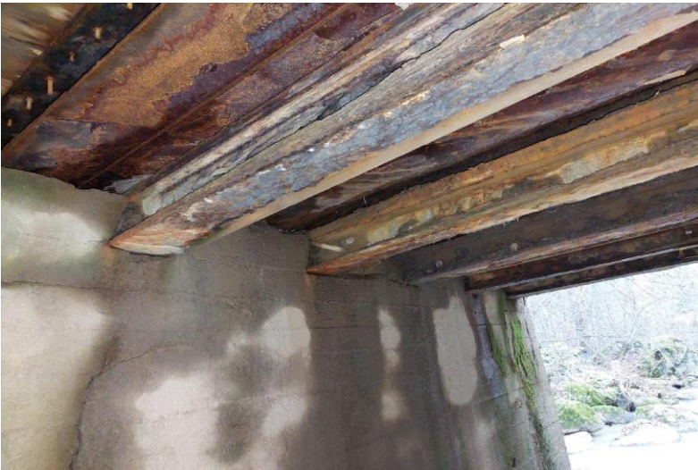
Korroosion vaurioittamaa teräspalkistoa. Myös perustuksessa näkyy halkeama. Tarkastustarve.
