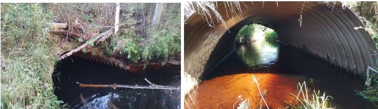
Liekopuut ja liiallinen maa-aines kannattaa poistaa ja samalla tarkkailla rummun koon riittävyttä. Kuvat: Hannu Ulvinen.
