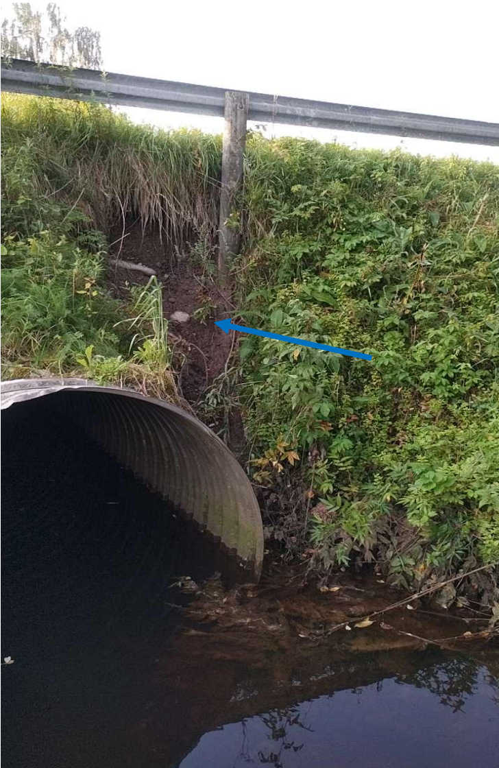
Luiskassa rummun päässä syöpymä. Vaatii pikaisen korjauksen.
