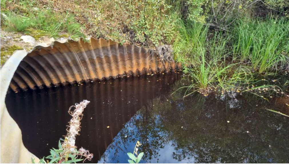
Hyväkuntoinen teräsputki, pientä pintaruostetta, seuranta vähintään viiden vuoden välein.
