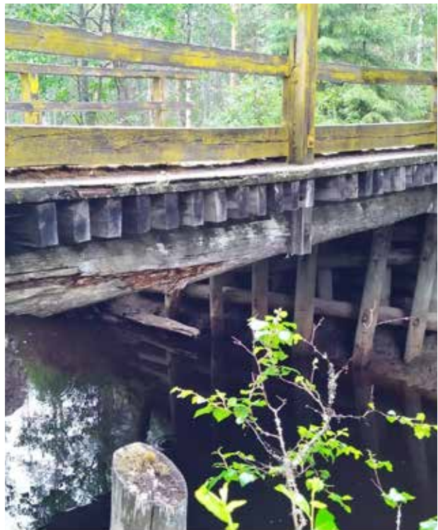
Ajan hammas on armoton. Siltavanhus on tiensä päässä ja odottaa uusimista.
